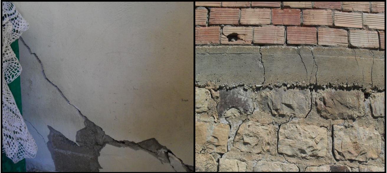
Figure I.12 : Fissures et cisaillement sur les murs et les ceintures des bâtisses
