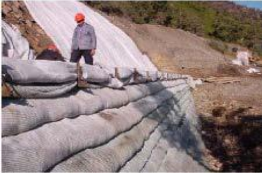
Figure V.4: L'utilisation du géotextile jouant un double rôle le drainage et le renforcement du talus.
