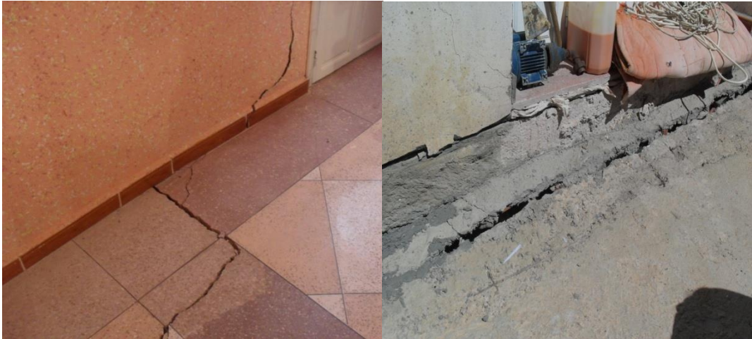
Figure I.10 : Le tassement des fondations d'une bâtisse récemment construite Et fissurations des murs
