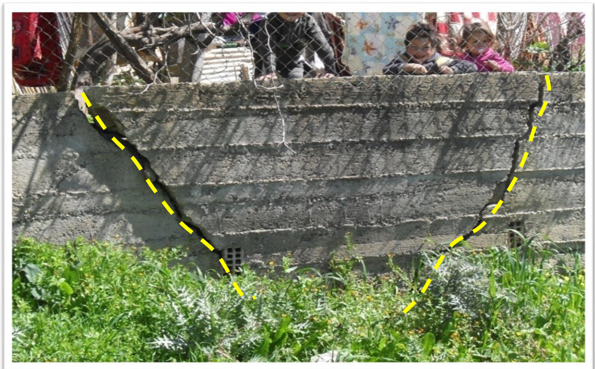
Figure I.11 : Cisaillement et fissuration d'un mur de soutènement sous l'effet des poussées des terres
