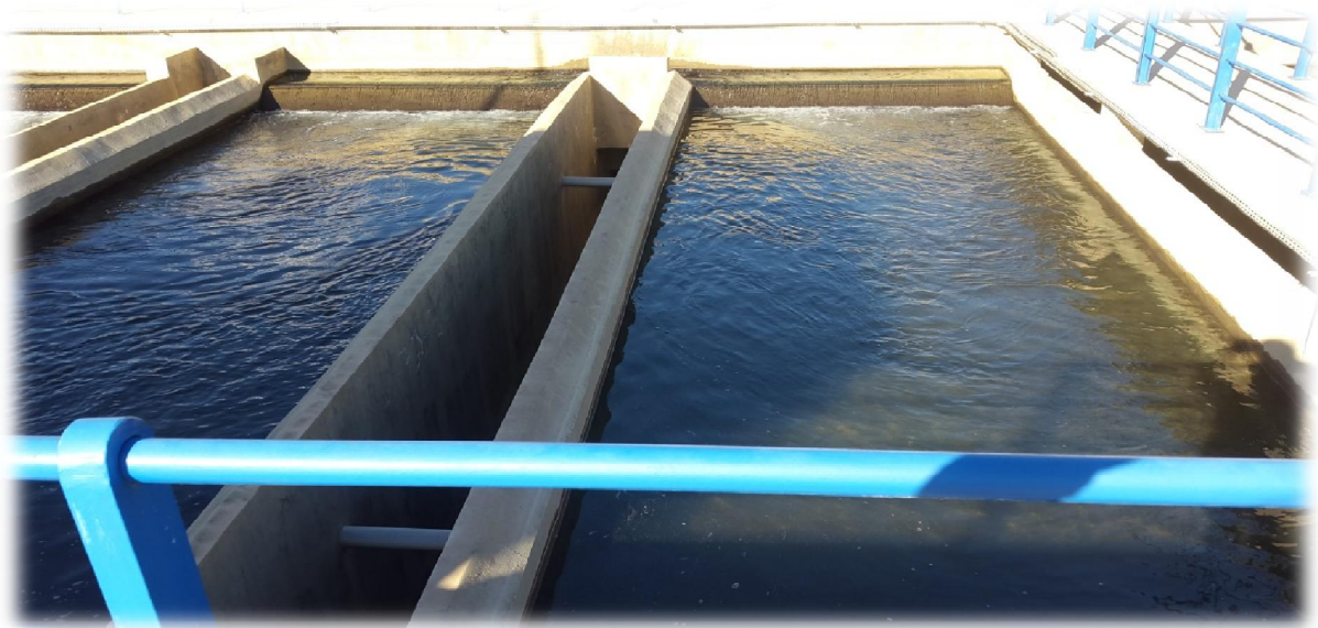
Figure III.12 : Les filtres à sable (station du barrage Tilesdit).
