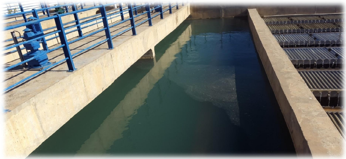
Figure III.8 : bassin de floculation (station du barrage Tilesdit).
