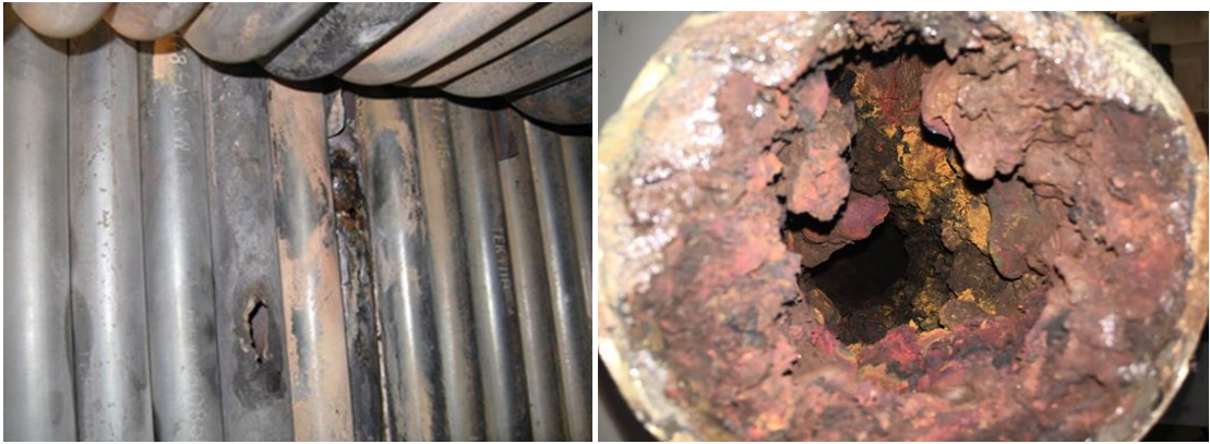
Figure I.23 : dégâts des dépôts d'encrassement dans la surface d'échange. [5]
