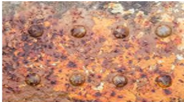
Figure 20 : Corrosion de rivet
