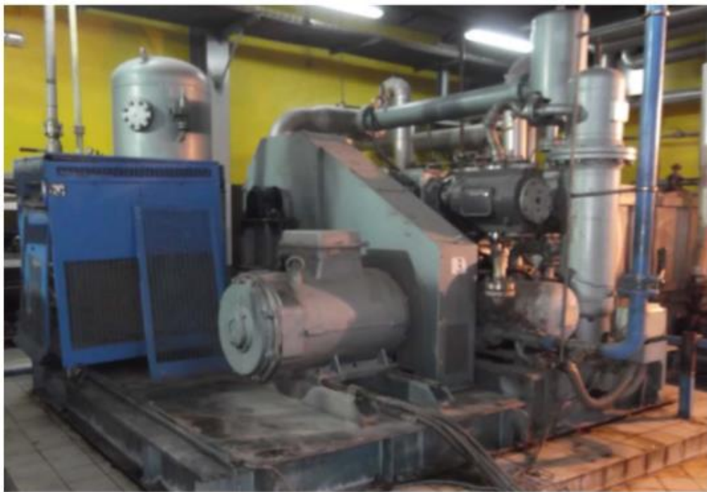
Figure II.9 : Compresseur ATLAS COPCO CREPELLE [9].
