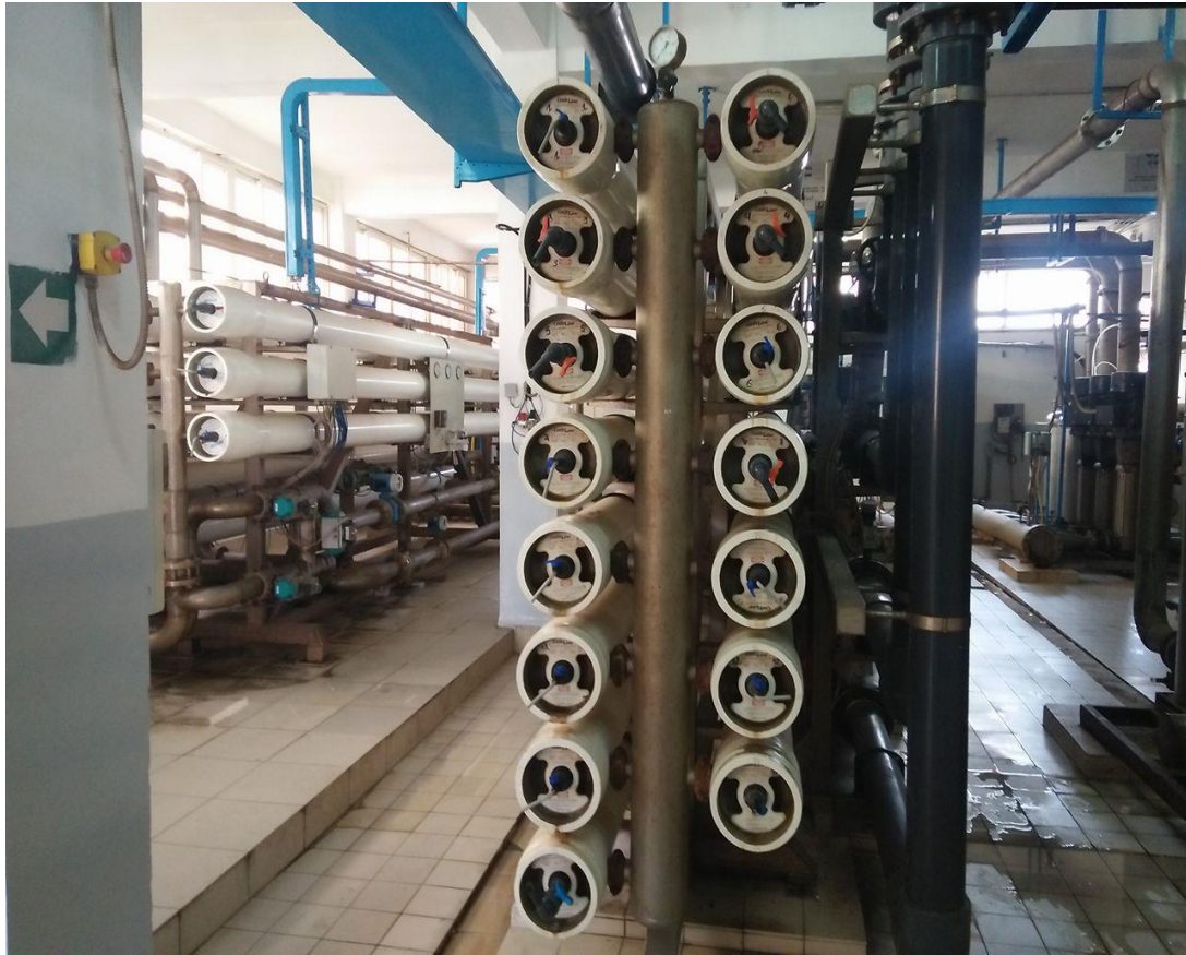
Figure IV.4 : la ligne d'osmose inverse de CEVITAL.
