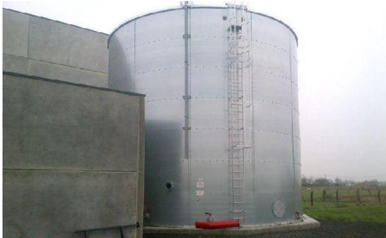
Figure I.11 : Réservoir de stockage d'eau.
