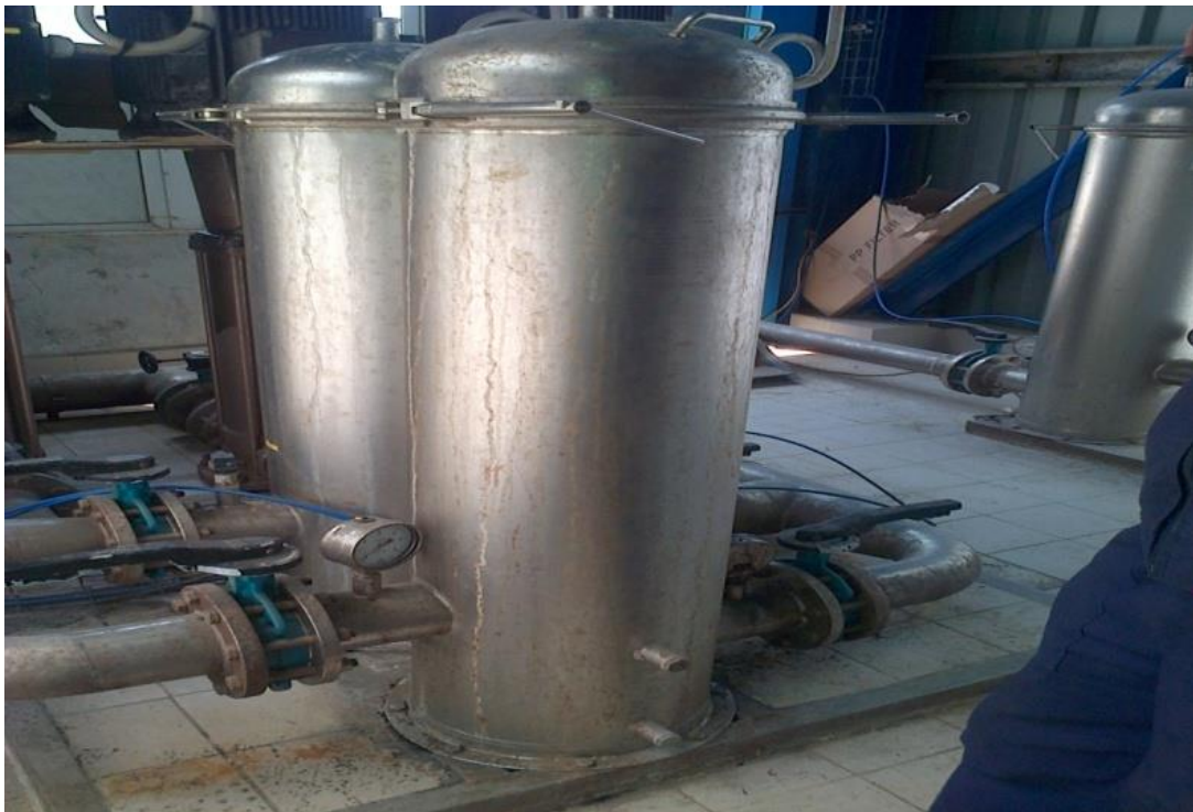
Figure I.3 : Face externe des filtres à cartouches utilisées au niveau de Cevital.
