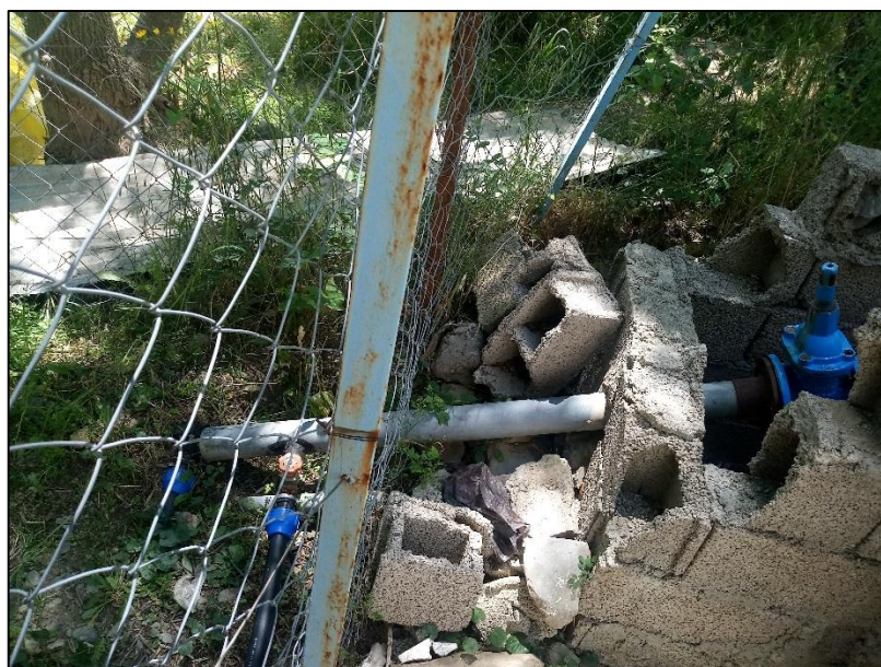
Photo 25 : Clôture dégradée et non réparée de la vanne de sectionnement
