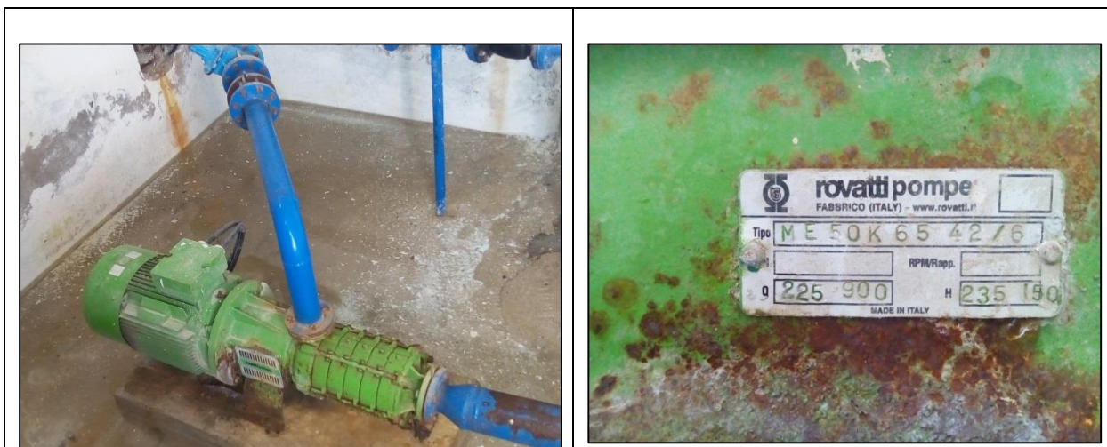
Photo 17 : Le GEP de sa plaque signalétique de la SR1
