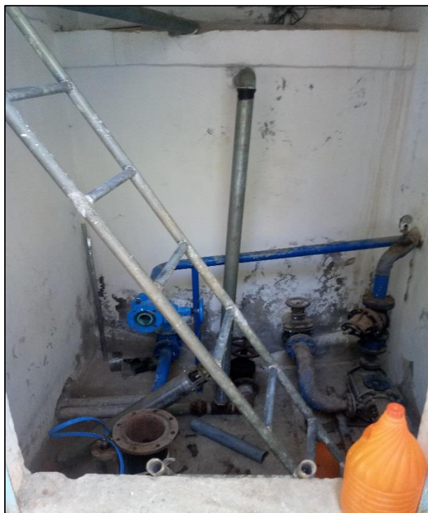
Photo 24 : L'intérieur désordonné et non entretenu de la salle à machine de la SR2
