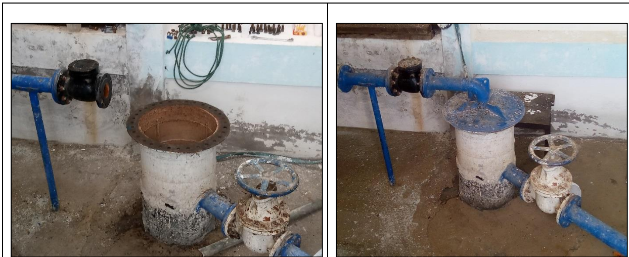
Photo 16 : La pompe immergée de la SR1 en panne
