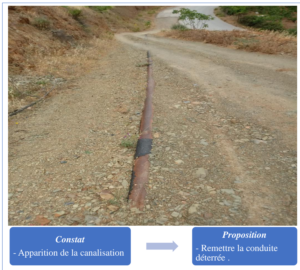
Figure (II-12) : La conduite d'adduction entre les stations de reprise SR4 et SR5
