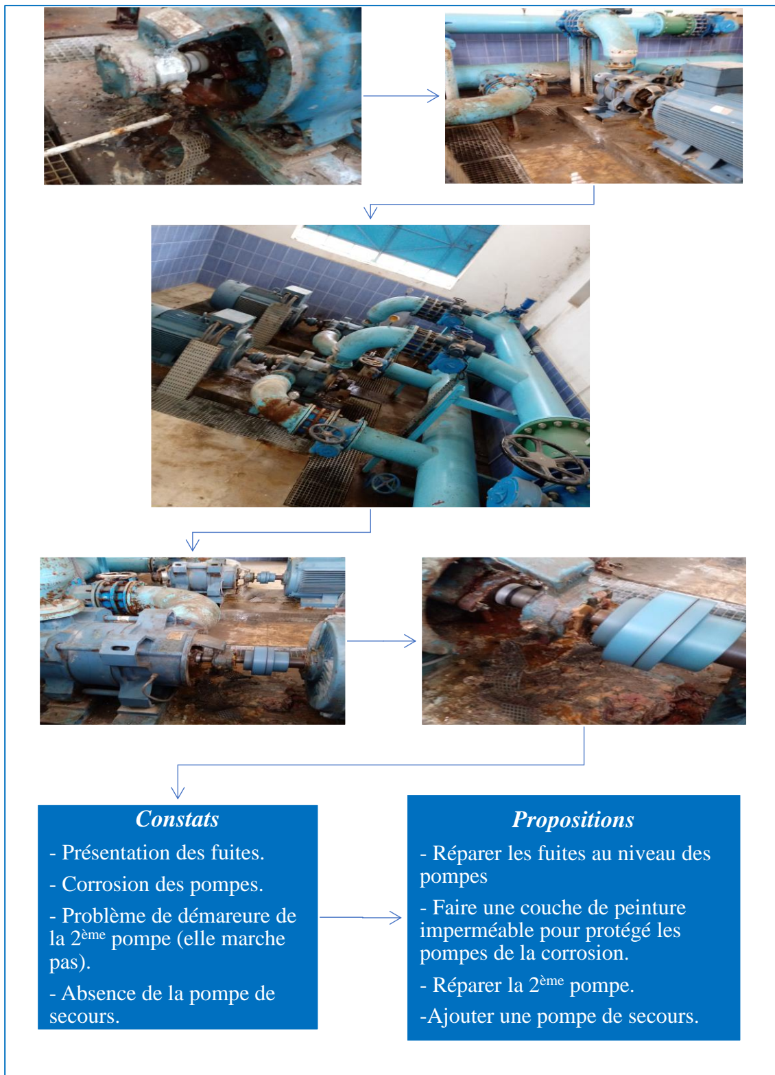
Figure (II-6): La chambre des pompes de la SR3 de Lemri
