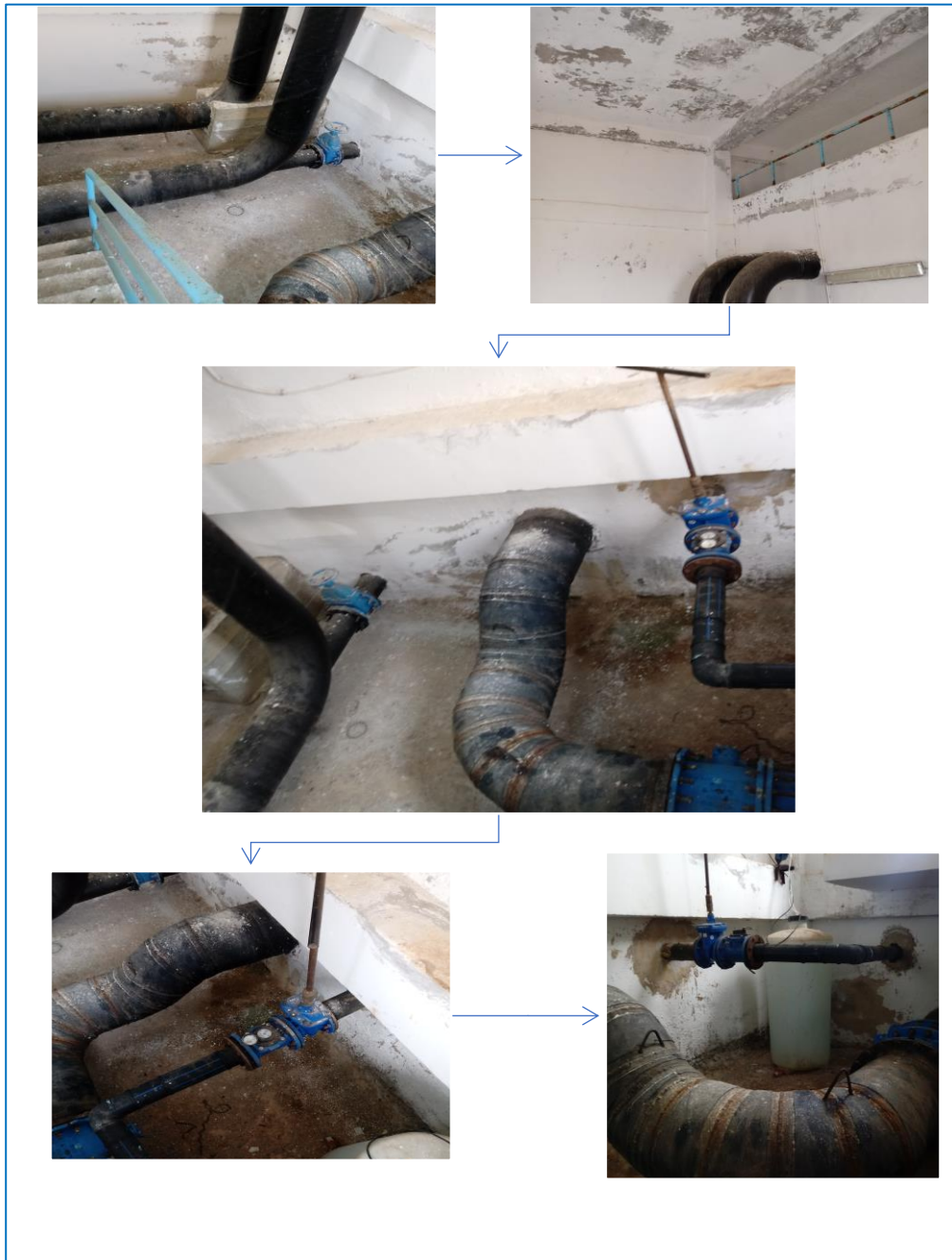
Annexe (3) : Chambre de vanne du réservoir de la SR4 de Thanouthine
