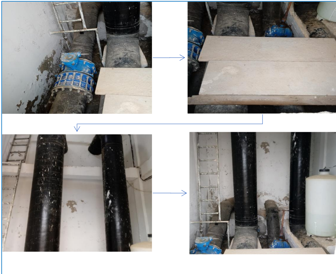
Annexe (4) : Chambre de vanne du réservoir de la SR5 de Thaberthot
