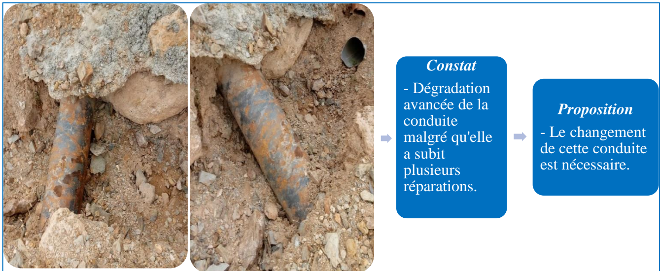
Figure (II-13): La conduite d'adduction entre la station de reprise SR5 et le réservoir final de Tighermine
