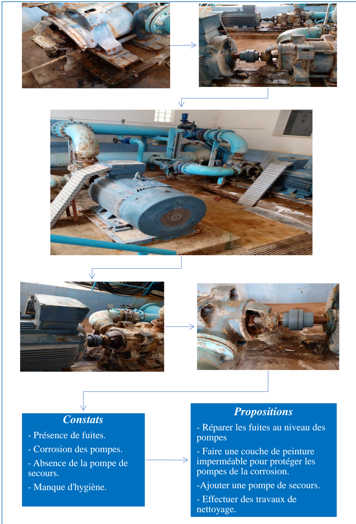
Figure (II-7) : La chambre des pompes de la SR4 de Thanouthine
