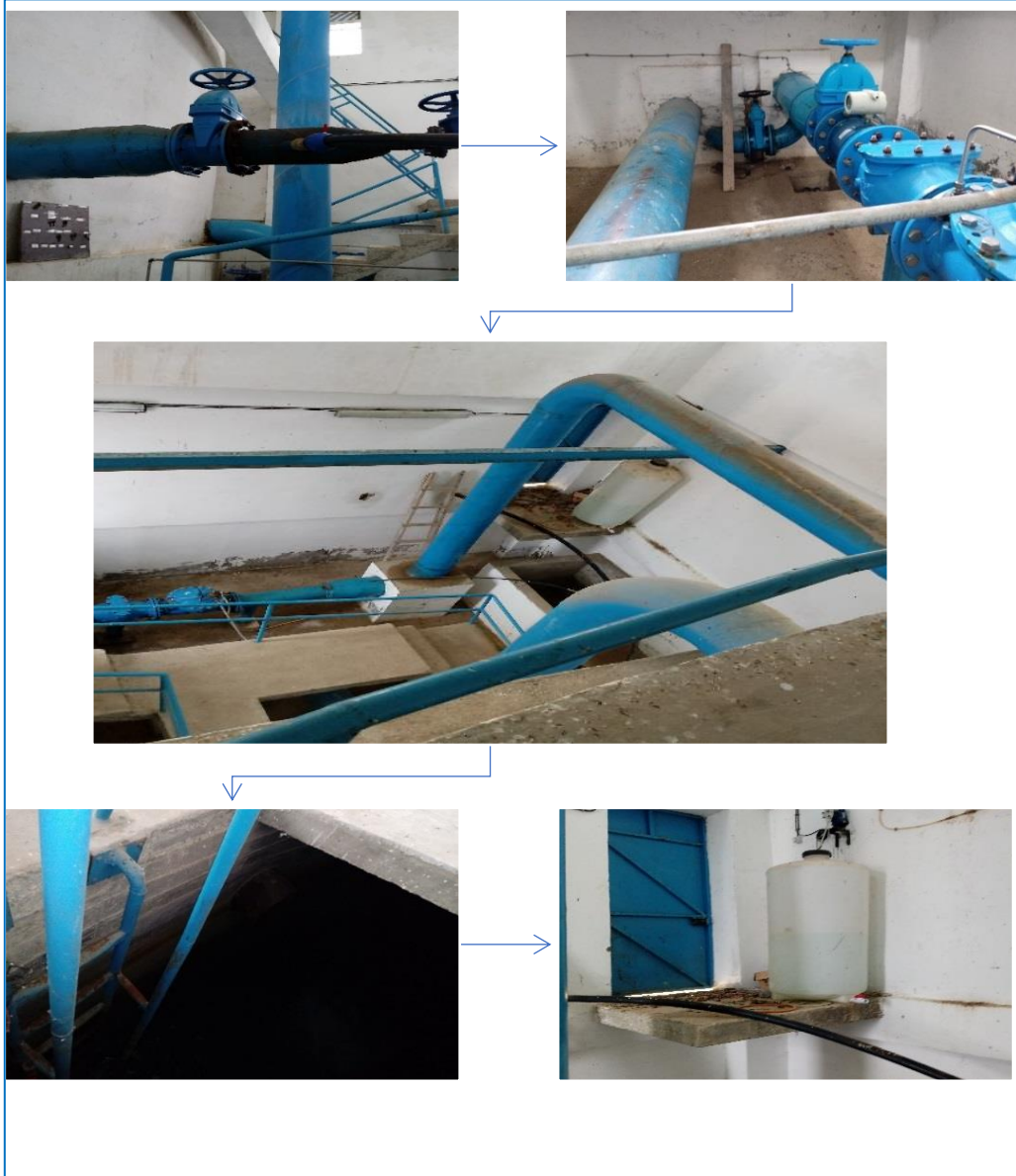
Annexe (1) : Chambre de vanne du réservoir de la SRI d'Ighzar-Lkim
