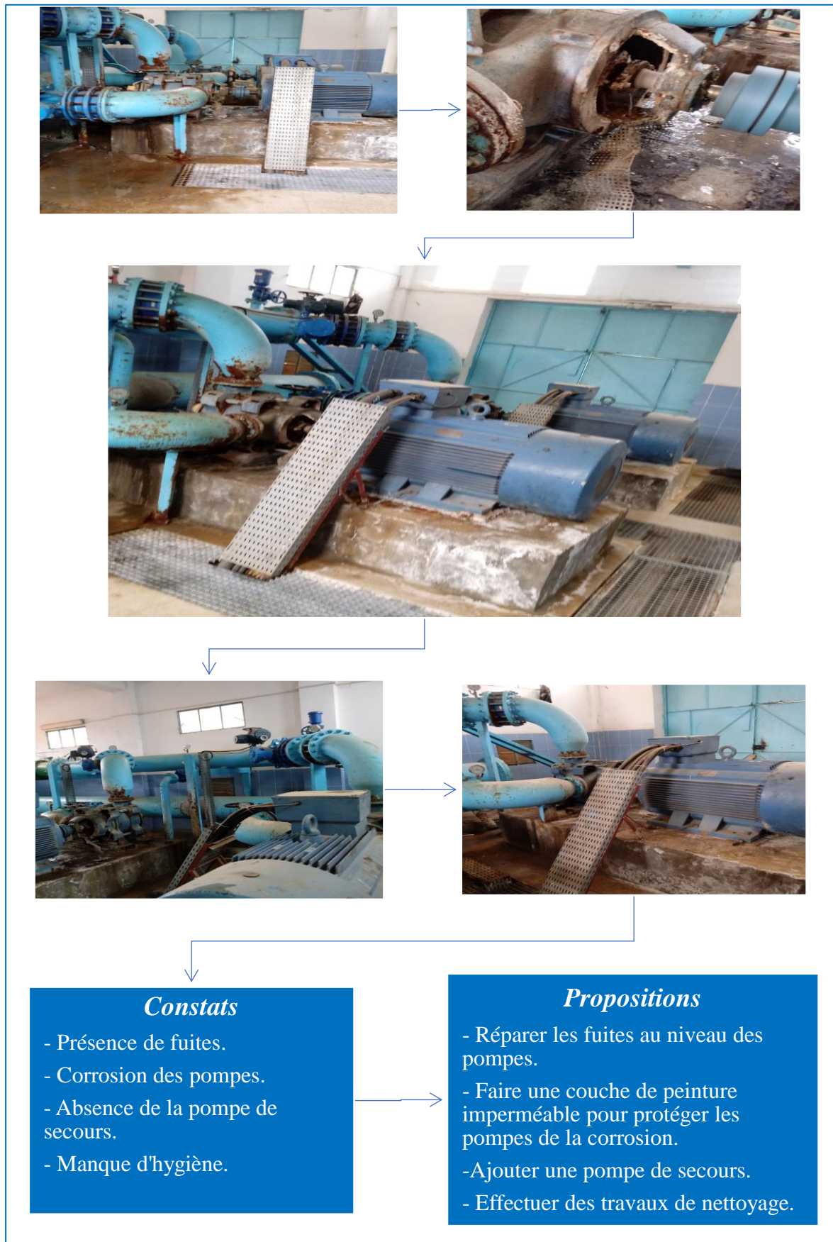
Figure (II-8) : La chambre des pompes de la SR5 de Thaberthot
