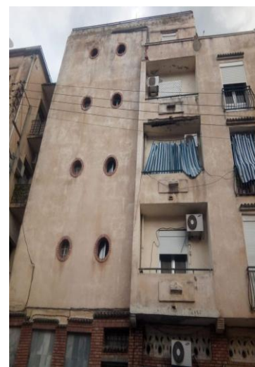
Figure 131: Une maison, vétuste en 02 ème degré. (Source : Auteur)
