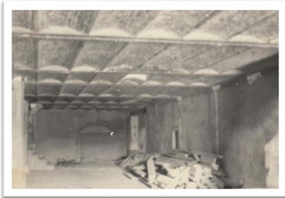
Figure 66: Vue sur le plancher intermédiaire ajouté par les français, Source : OGEBC Bejaia
