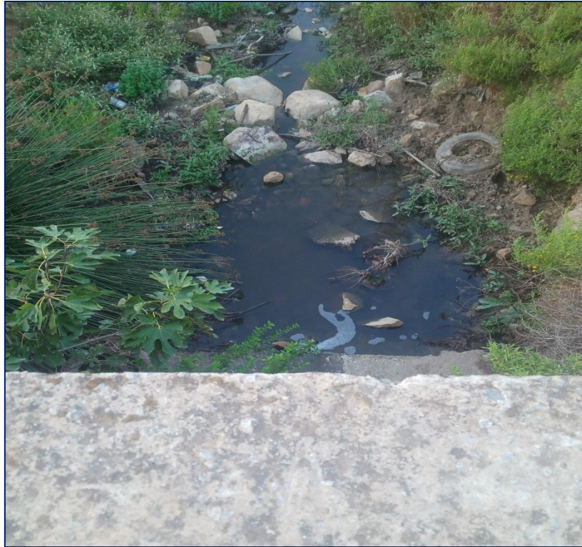
Fig. 3: Eaux sanitaires rejetées directement dans un cours d'eau (Jijel).
