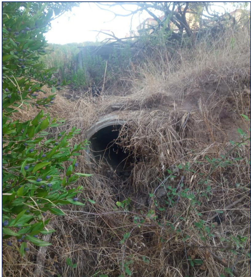
Fig. 4: Rejet des eaux usées directement dans le milieu récepteur (Essettah-Jijel).
