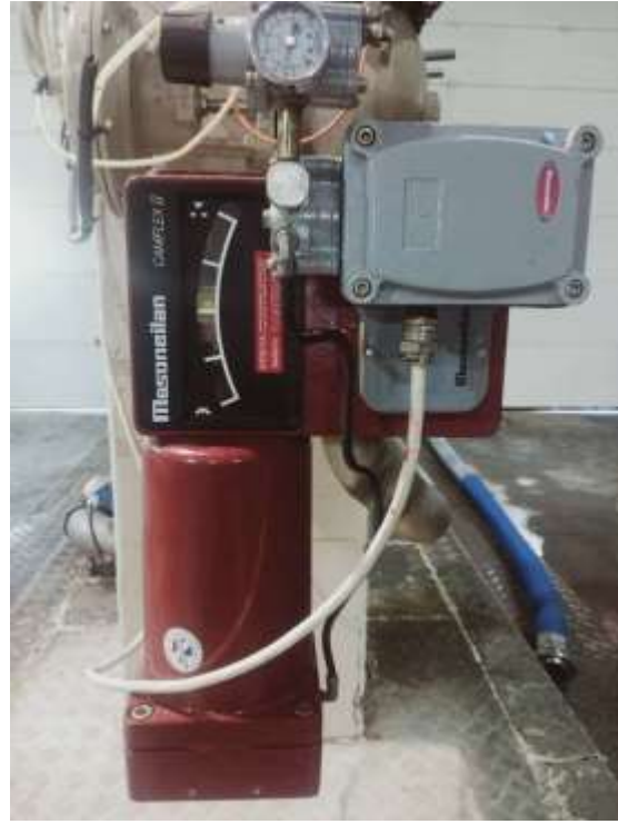
Fig.I.8 La vanne régulatrice (PCV640)
