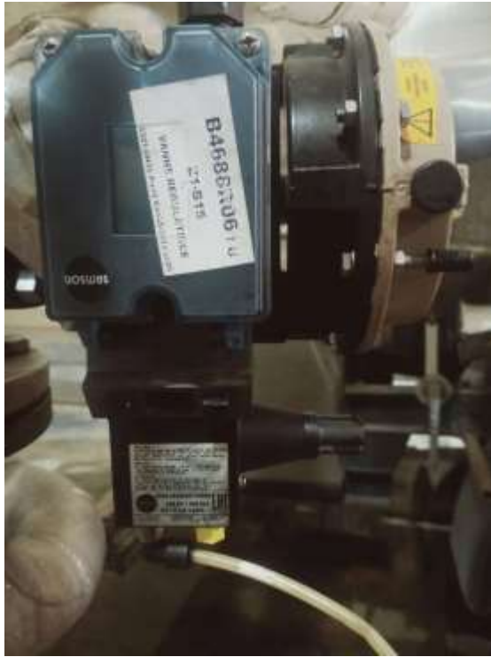
Fig.I.7 La vanne régulatrice (TCV 600)
