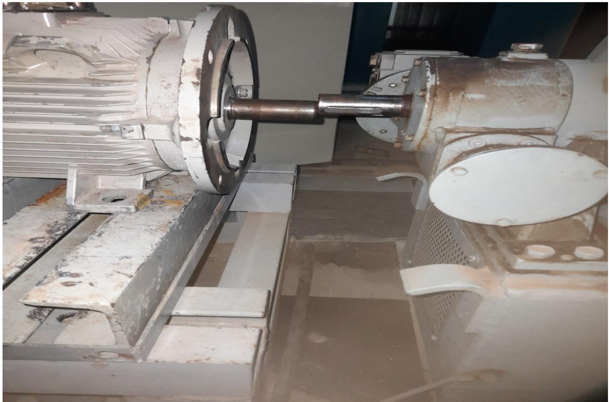
Figure (II.5) : Alignement des deux machines n'est pas constatables
