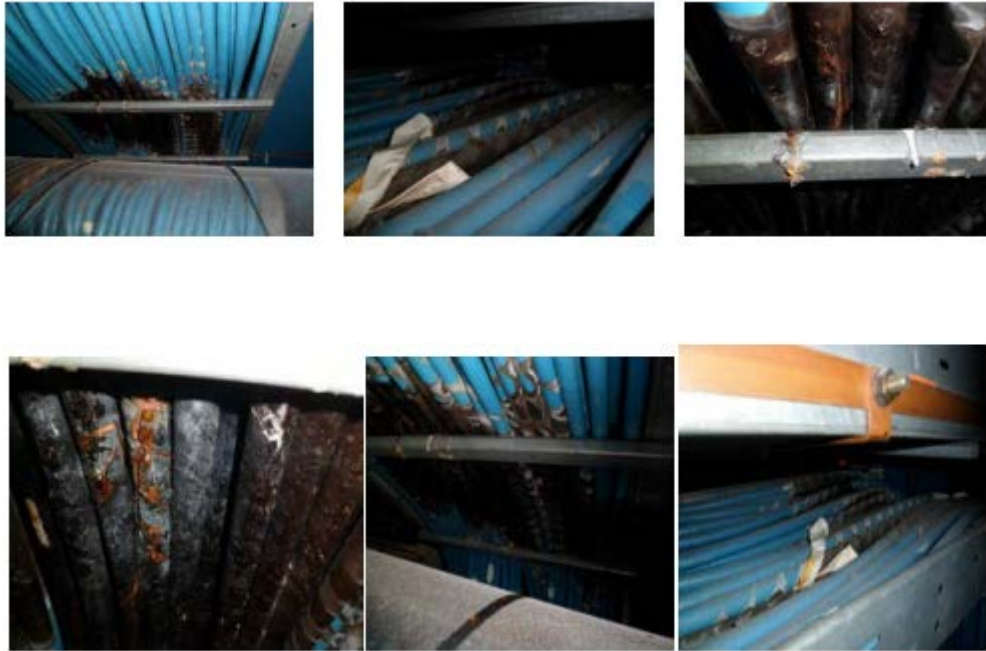
Figure I. 15: Câbles localement endommagés (images EDF) [3].
