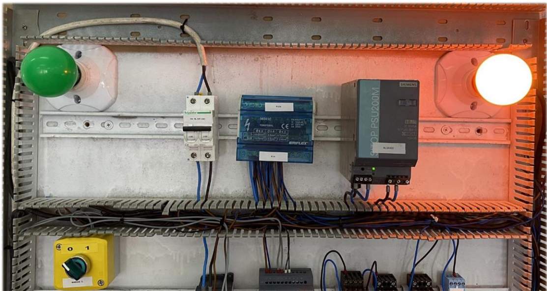
Figure III.21 : Arrêt du moteur convoyeur avec activation de la lumière rouge.
