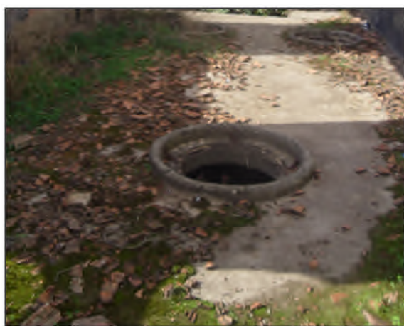
Photo 17 : Ouverture de remplissage d'une cuve, ferme Décoté. Tamba (Elkseur) .
