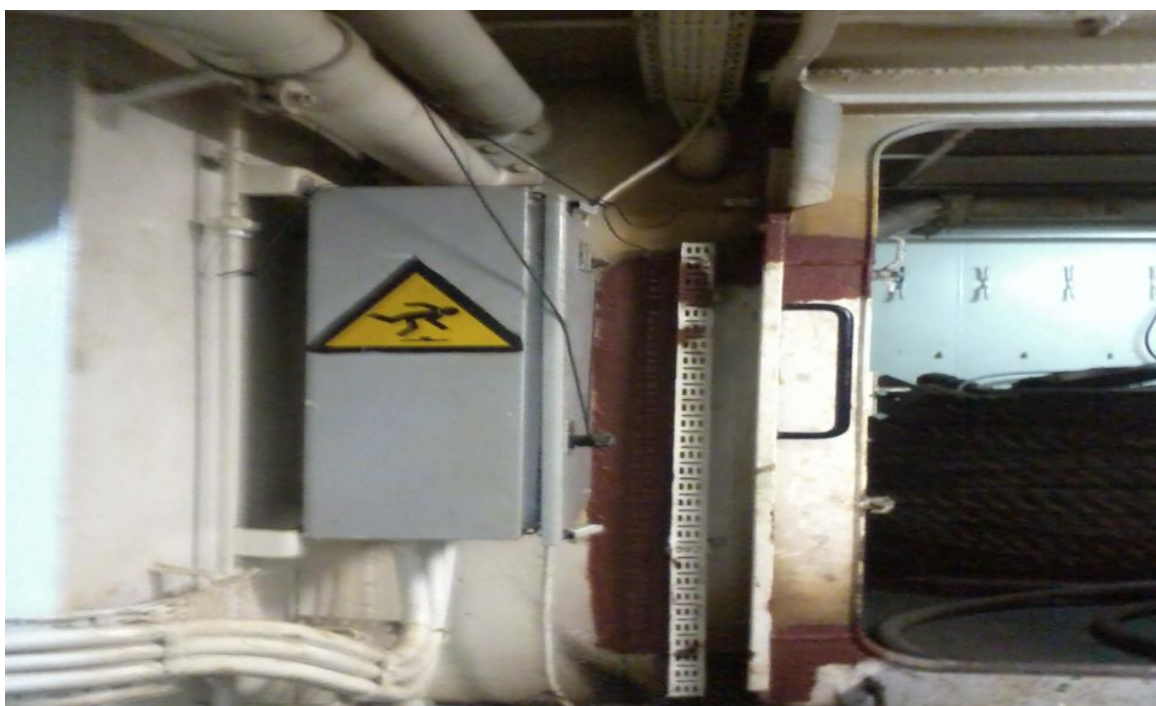
Photo n°11 : Indication d'un risque de glissade
