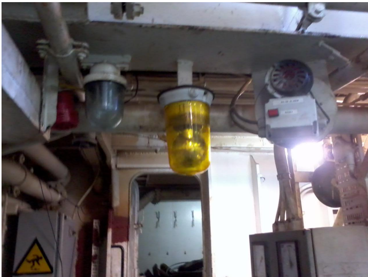
Photo n°14 : Sirène d'alerte en cas d'incendie
