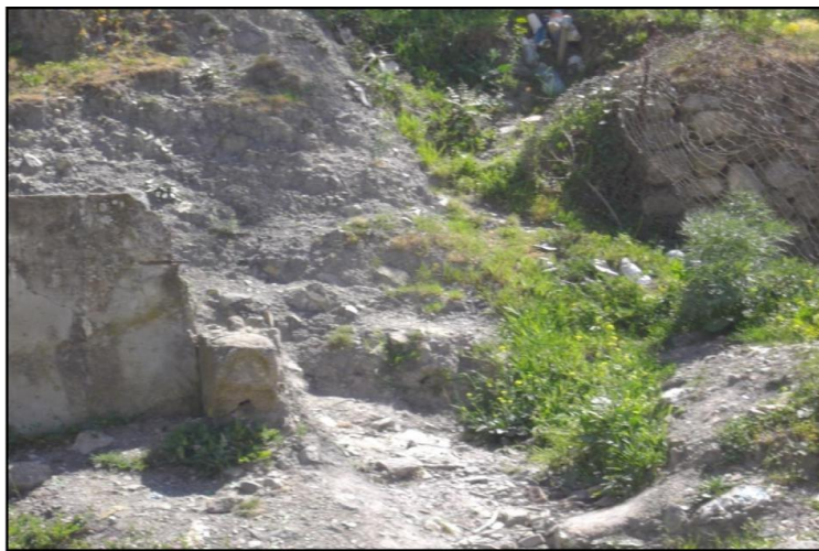
Figure (IV.3) : Création d'une ravine et rupture de mur de soutènement
