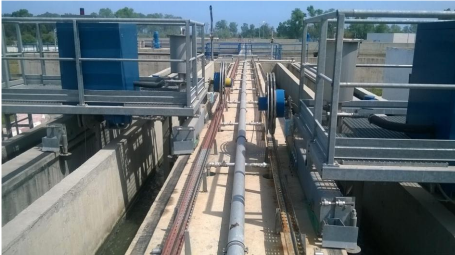
Figure I-5. Pont dessablage-déshuilage STEP SET.
