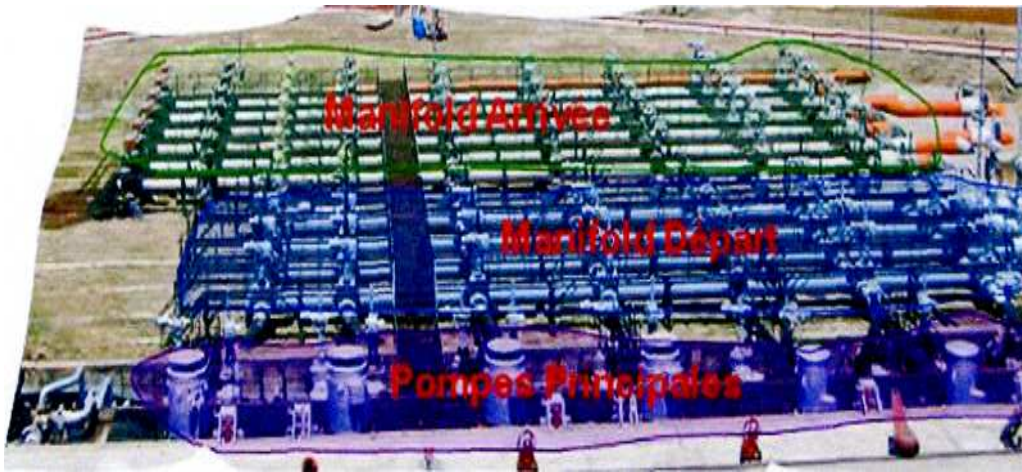
Figure IV.4.4 Aperçu du manifold
