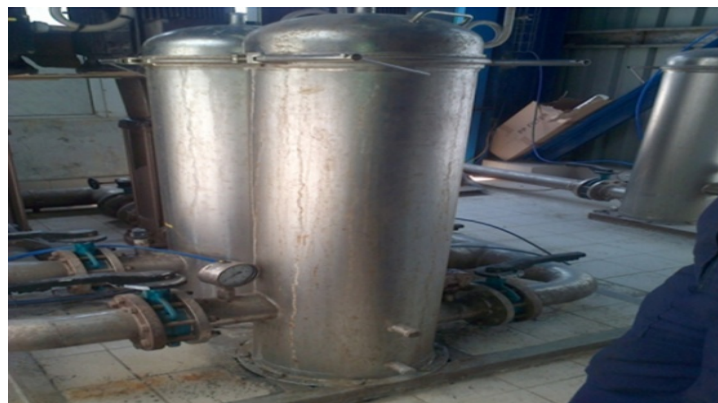
Figure N°6 : Face externe des filtres à cartouches utilisées au niveau de Cevital (Zatouche et Bouakkaz , 2012).
