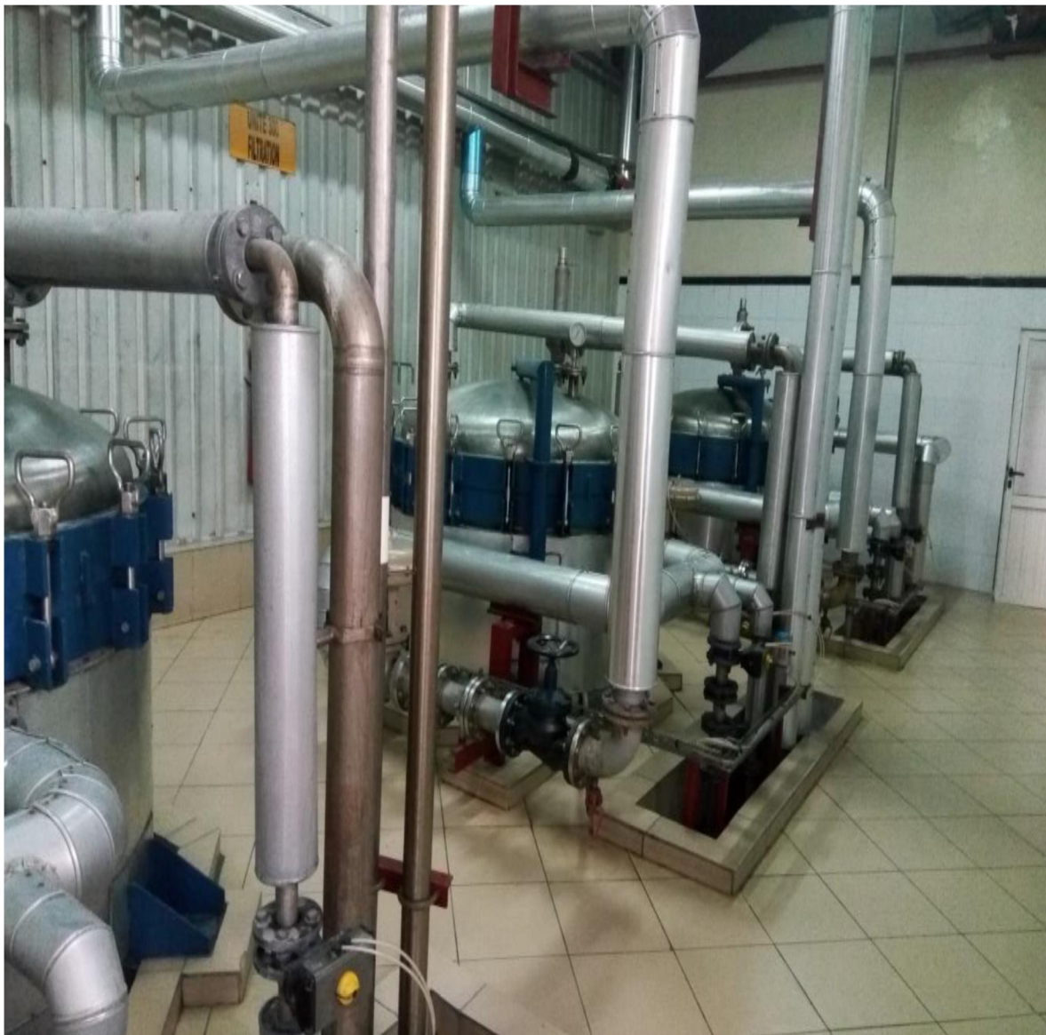
Figure II.1 : Vue extérieure des trois filtres Niagara F330A, F330B, F330C
