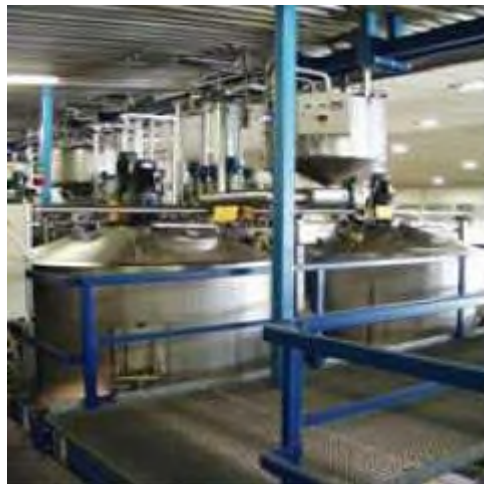
Figure I.3: Cuves de préparation d'émulsion [1].
