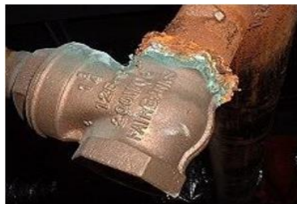
Figure I.4. Corrosion galvanique résultante d'un assemblage de deux métaux différents : robinet en cuivre et conduite en acier galvanisé.
