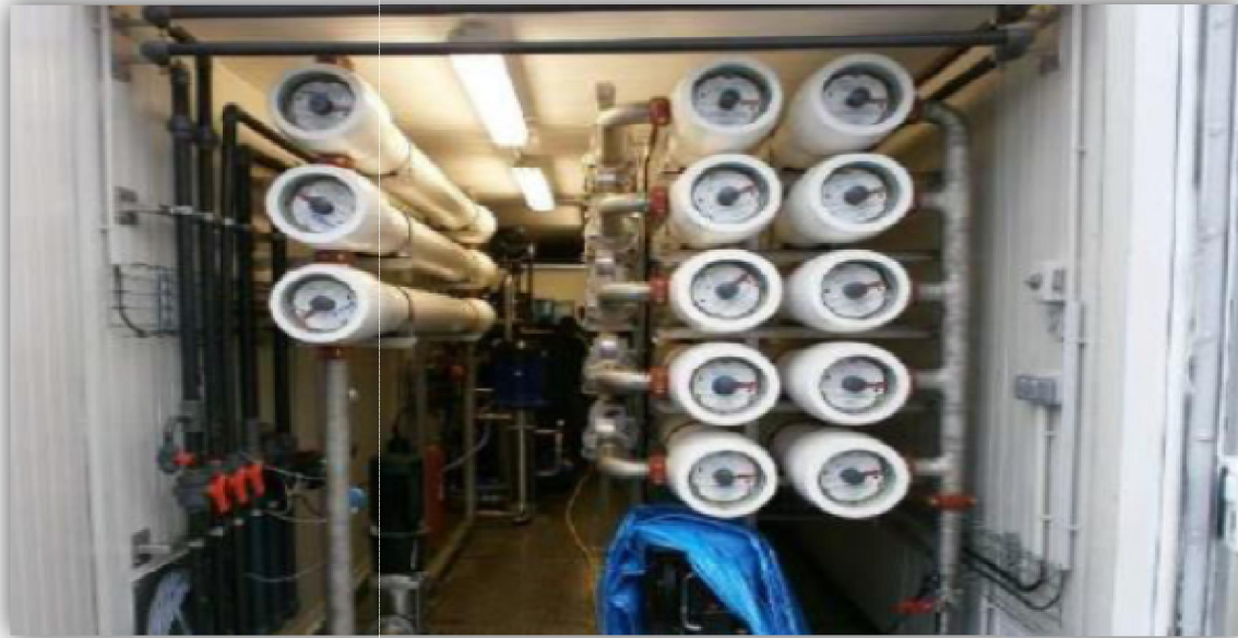
Figure V-16 : Monobloc de traitement de lixiviat par OI
