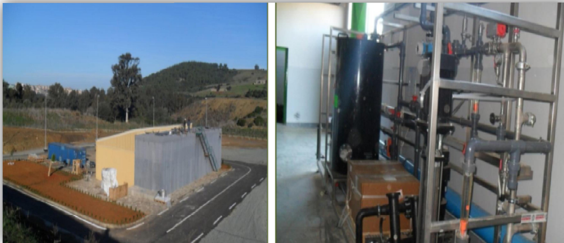
Figure V-15 : Station de traitement de lixiviat par BRM
