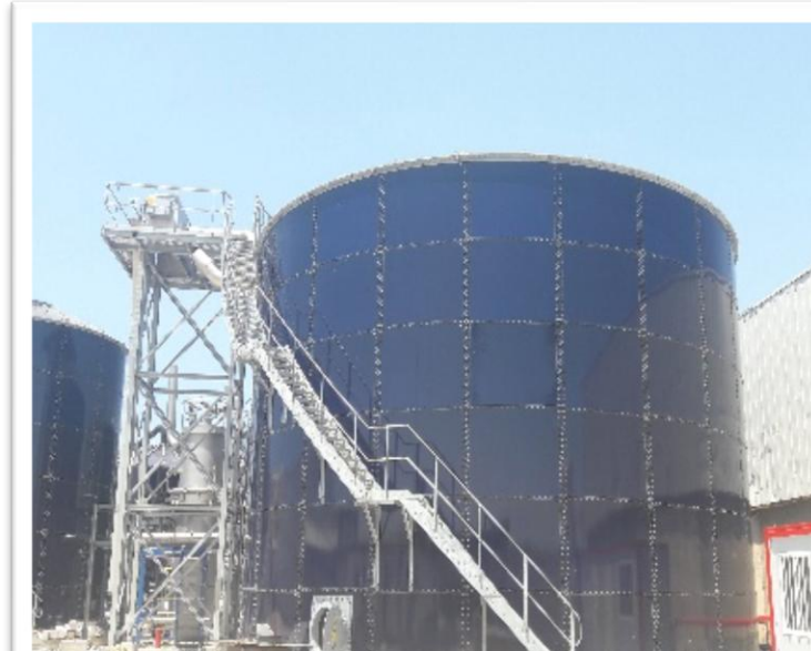
Figure (IV.5) : Photographie du réservoir de compensation
