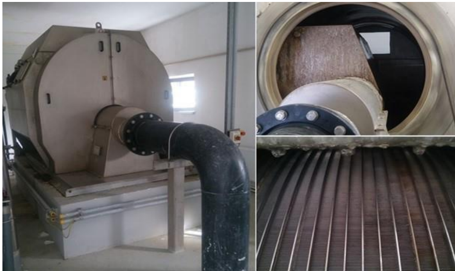
Figure (IV. 4) : Photographie du tamis à tambour rotatif
