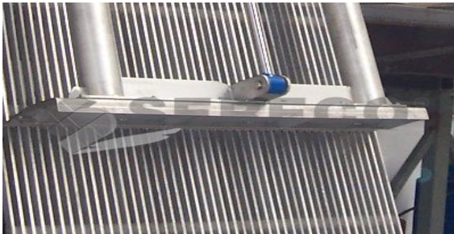
Figure IV.3 : Photographie de dégrilleur grossier
