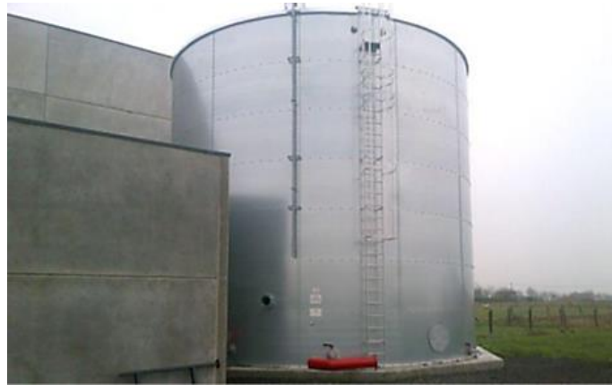
Figure II.12 : Réservoir de stockage d'eau.
