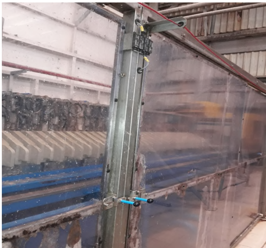
Figure I. 10 Panneaux de sécurité
