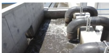
Figure N°8 : pompe de recirculation des boues
