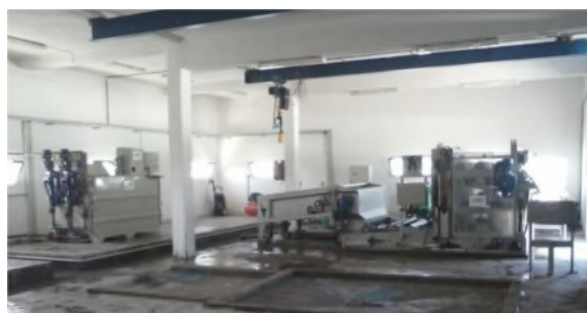
Figure N°10 : bloc de déshydratation des boues
