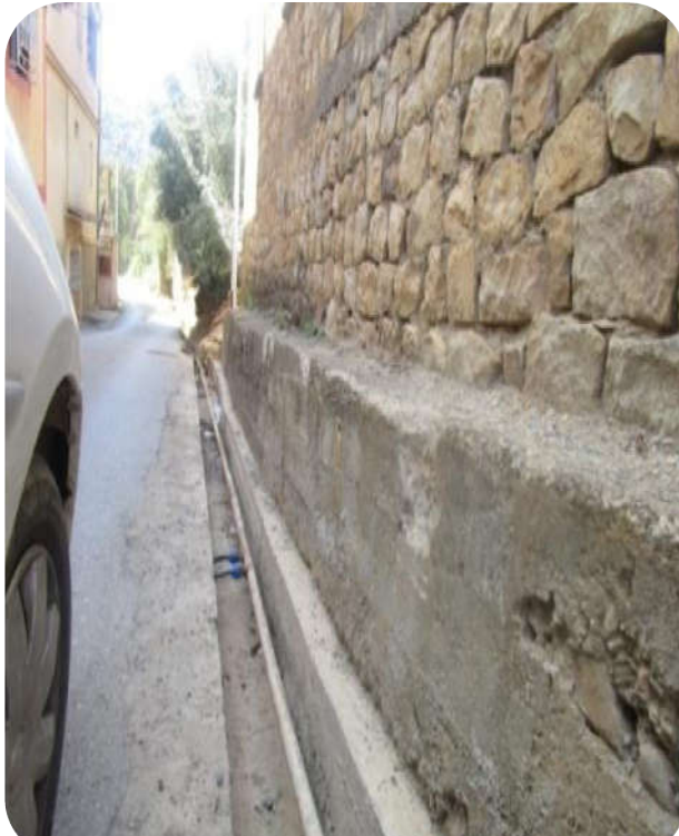
Conduite dans les caniveaux
