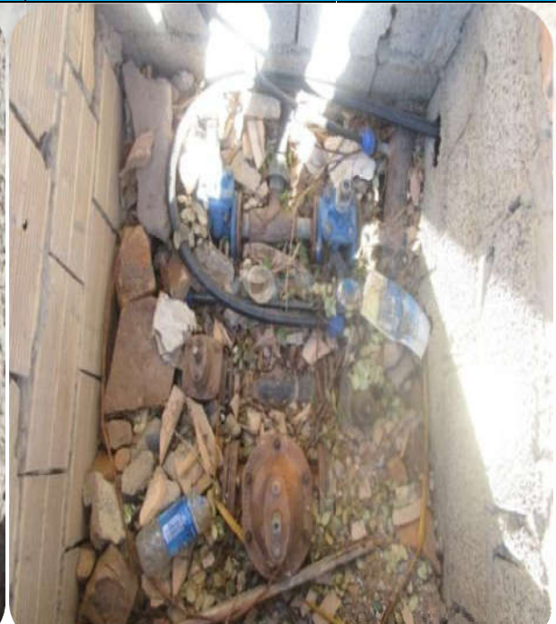
Regard de vanne détérioré et encombré
