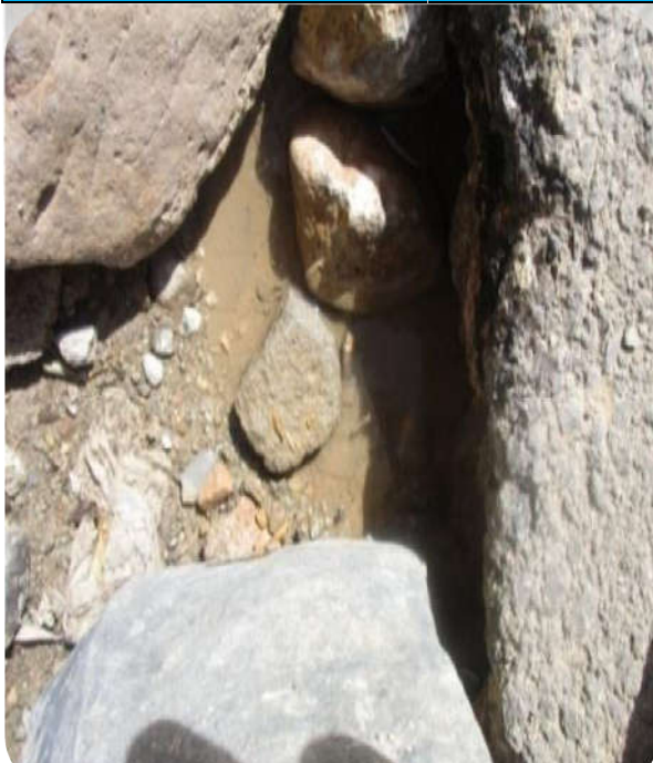
Fuite au niveau d'une vanne sans regard
