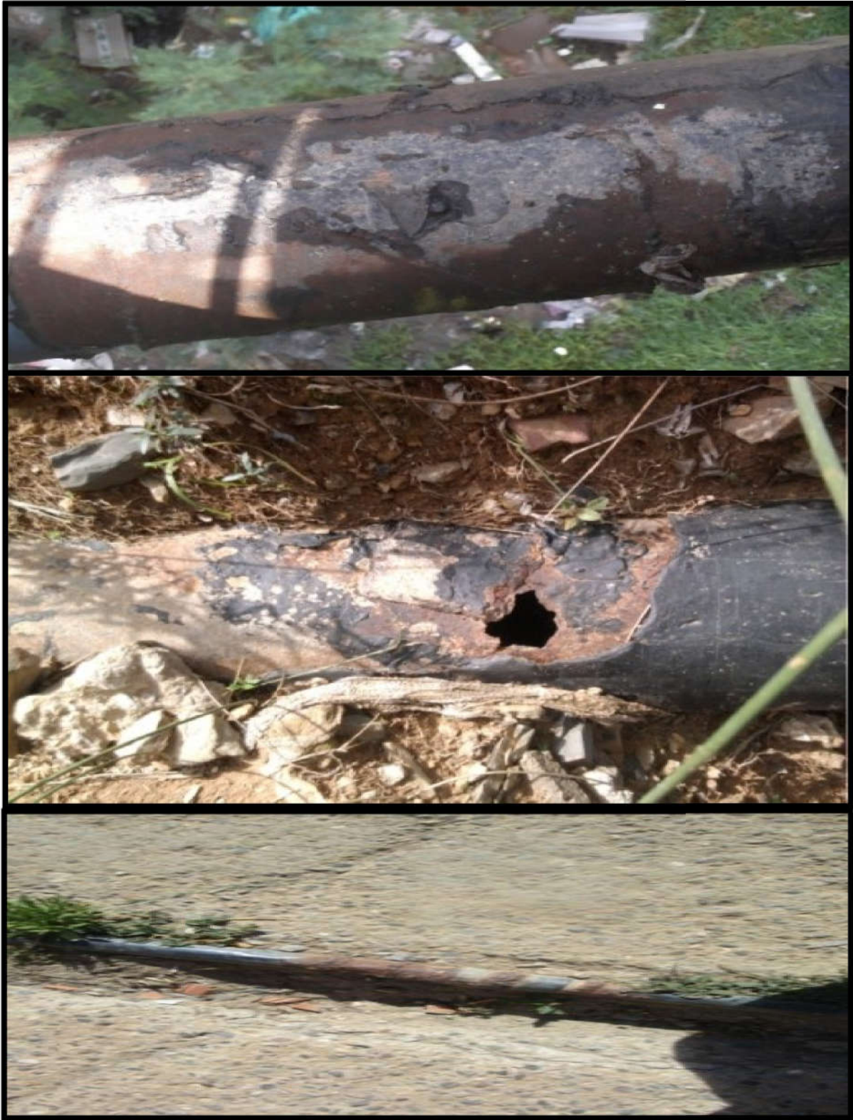
Figure (II.2) : Conduite déterrée et usée suite aux multiples réparations.
