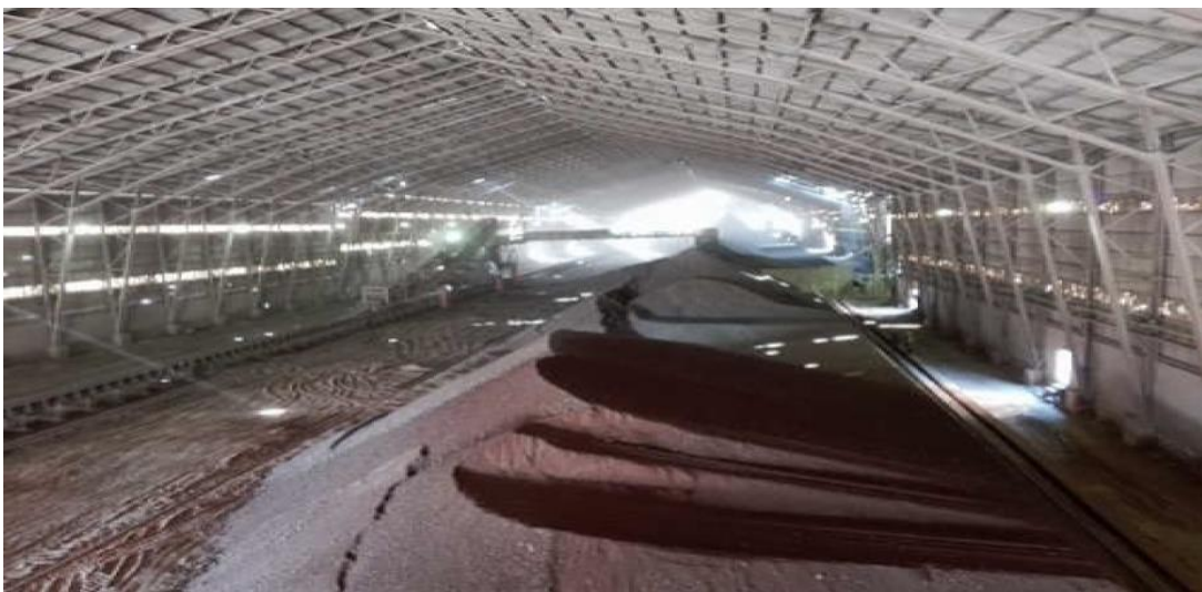
Figure I.4 : Hall de stockage et pré homogénéisation de la cimenterie de Sour El Ghoulane.
