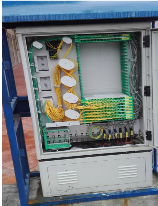
Figure II.3 : Sous Répartiteur Optique
