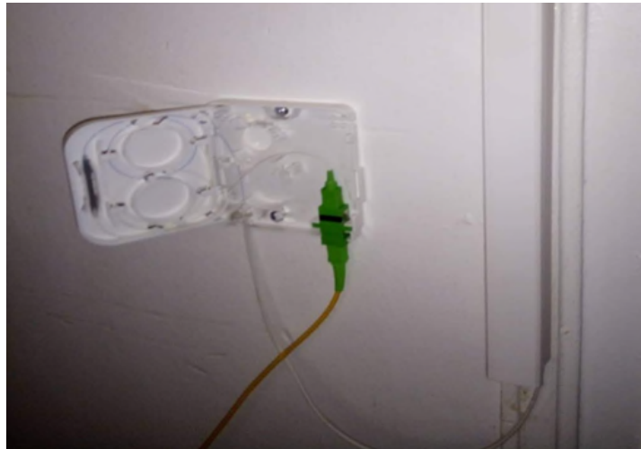
Figure II.5 : Prise Terminal Optique
