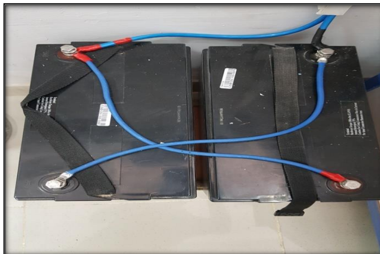
Fig. IV.7 : les batteries de (12V.100Ah)
