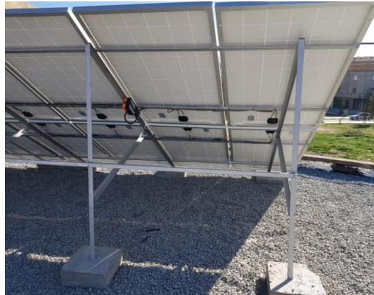
Fig.III.9 : Structure porteuse de module photovoltaïque
