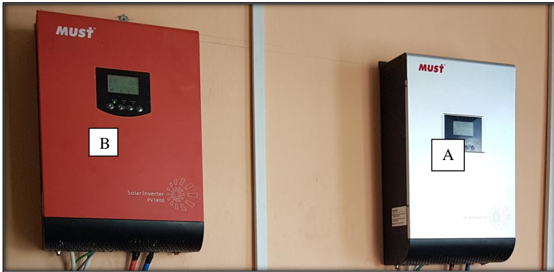
Fig.III.5 : A est l'onduleur de (5000VA/48) et B l'onduleur de (3000VA/24)
