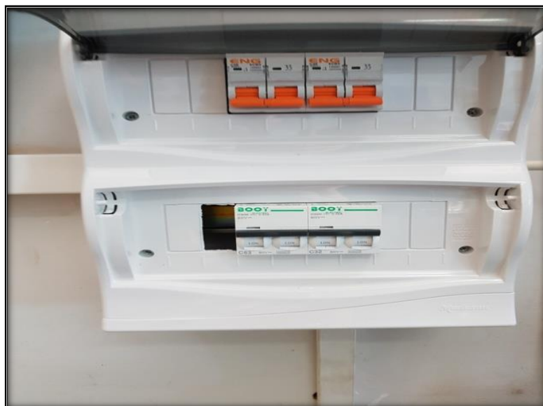
Fig. IV .4 : la boîte des disjoncteurs
