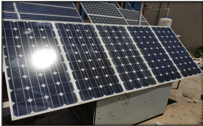
Fig. IV .2: Les panneaux photovoltaïques de (80W/ 12 V)
