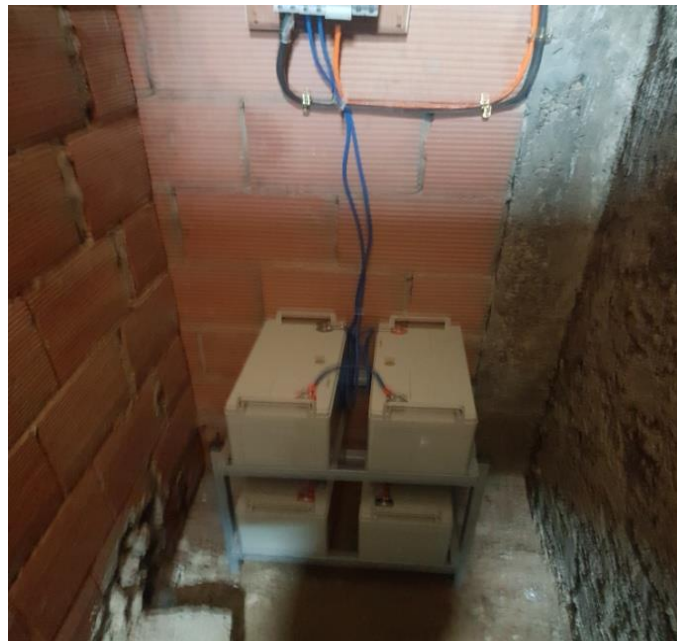
Fig.III.22 : brancher les batteries en parallèle (24V/100 Ah)
