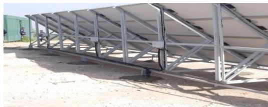
Fig. III.3: Structure porteuse de module photovoltaïque
