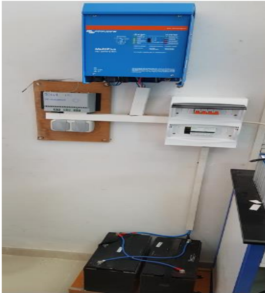
Fig. IV .8 : réalisation final du système dans la salle
