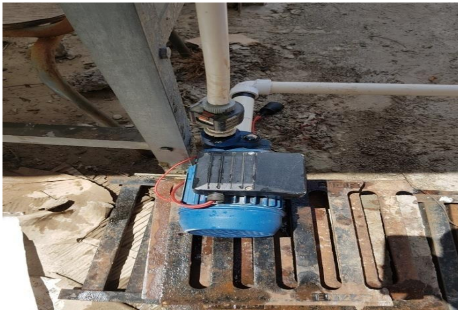
Fig. IV .9 : la charge (pompe centrifuge de 370 W)
