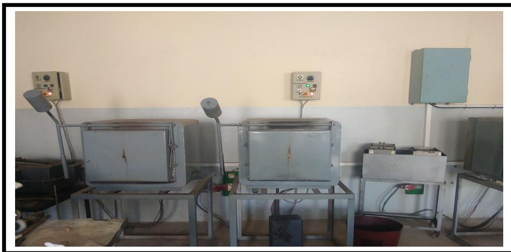
Figure II.6 : Fours à haute température.
