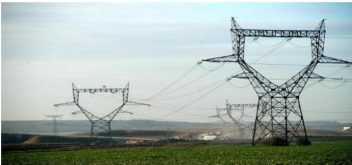
Figure I.11 : les lignes électriques aériennes [13].
