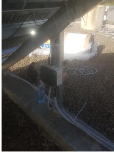
Figure III.5 : La boîte de jonction connecté au panneaux
