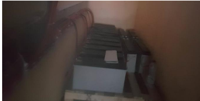
Figure III.7 : Parc de batterie
