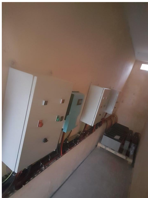
Figure III.26: Les onduleur, les batteries et les armoires électrique après l'installation
