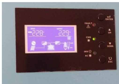
Figure.25 : L'onduleur plein fonctionnement
