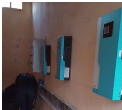
Figure III.10 : Les 3 onduleurs de 5 kVA
