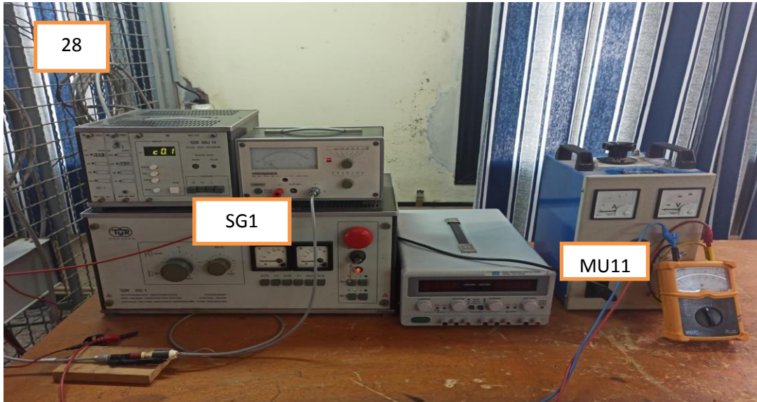
Figure (III.7) : Équipements de l'installation haute tension utilisée.
