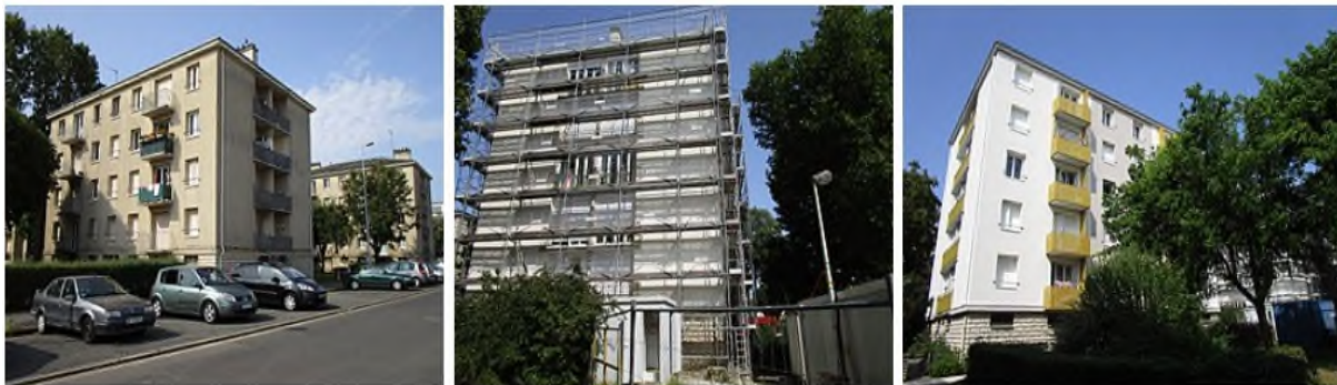
Figure 103: La cité de la Merlusine en 2017 avant, pendant et après réhabilitation, dans le quartier Giraudeau de Tours
