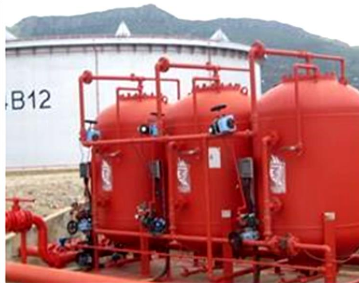
Figure 2-11. Projet de réalisation d'un réseau anti-incendie en fibre de verre des installations au port pétrolier de Bejaia
