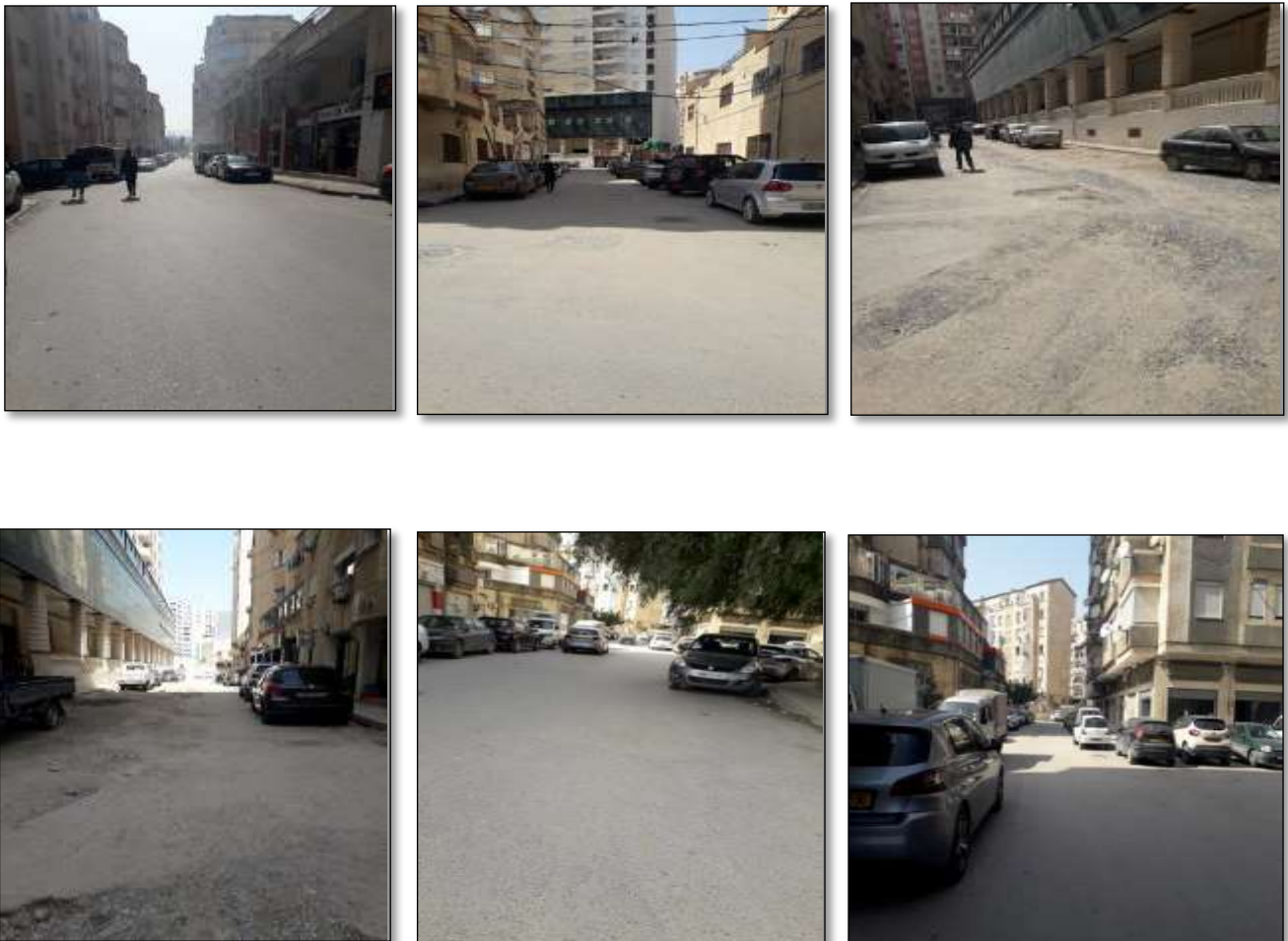
Figure 101 : quelques photos qui montrent l'état des voies tertiaires. Source : auteur
