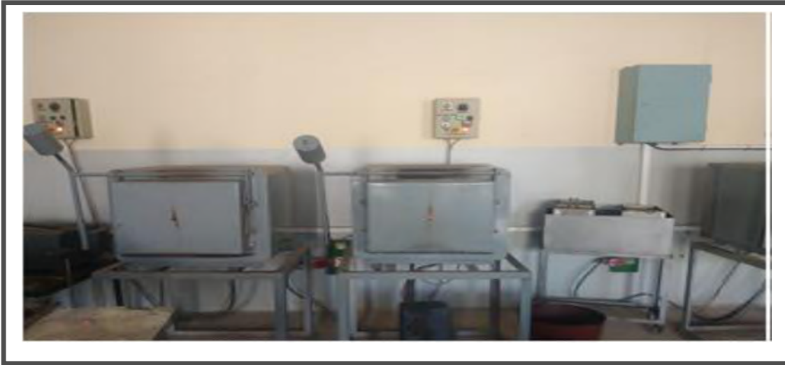
Figure II.8: Les fours de traitement thermiques
