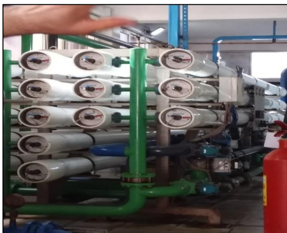
Figure III.2 : Photographie des lignes d'osmose inverse à CEVITAL.
