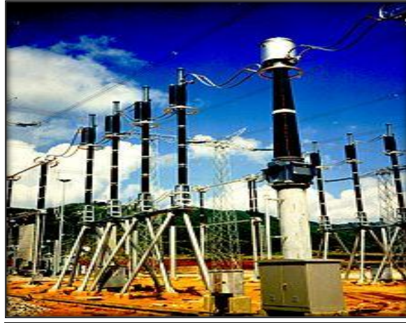
FigII.1 : disjoncteur d'un réseau à haute tension.
