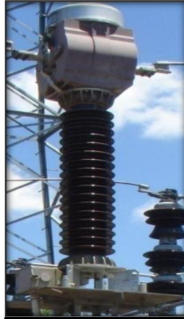
Fig II.4 : transformateur de courant.
