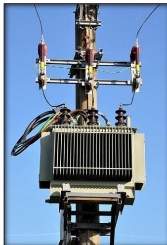
Fig II.5 : transformateur de tension.
