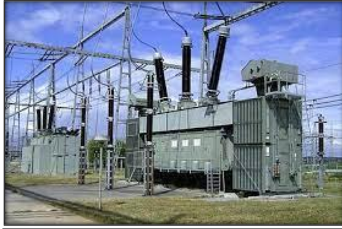
FigII.7 : transformateur de puissance.
