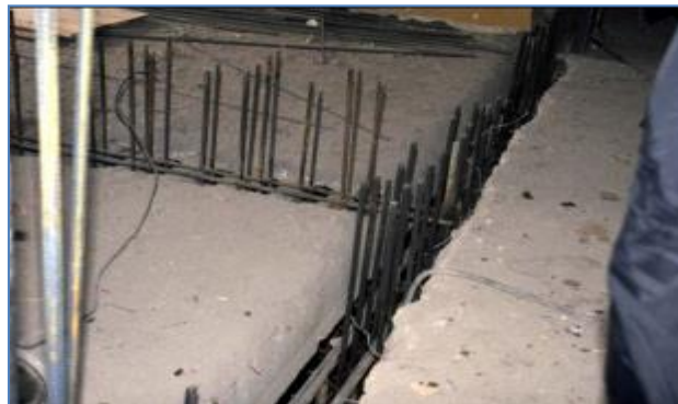
Figure 83. Partie piquée des poutres
