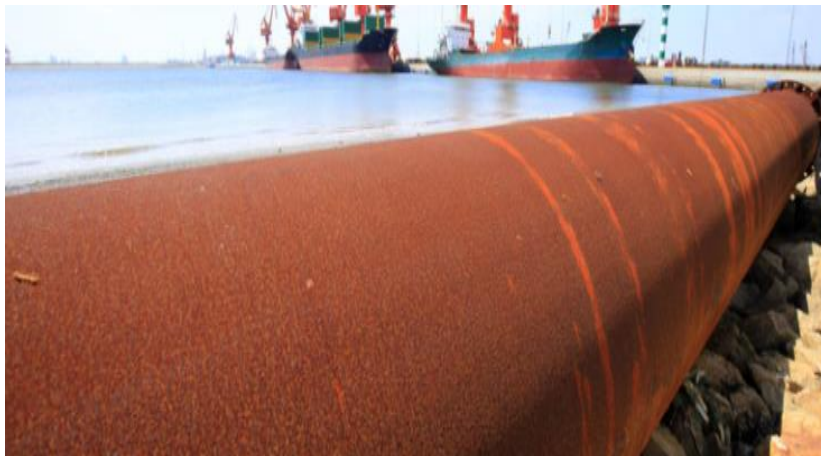
Figure I.2- Corrosion uniforme d'un pipeline.
