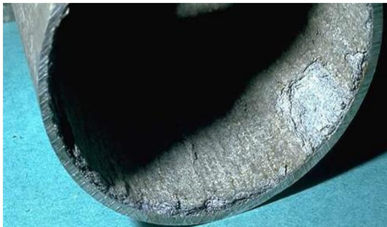
Figure I.6 -Corrosion intergranulaire d'un pipeline [3].
