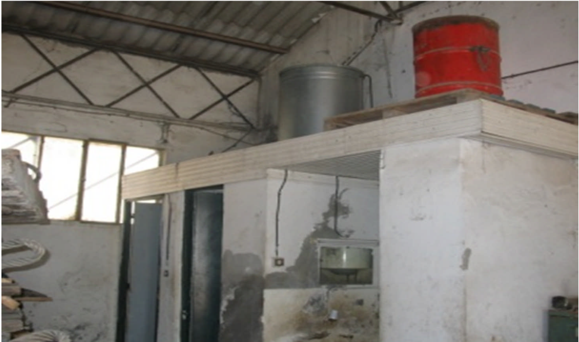
Photo N°07 : Le manque de la moindre condition d'hygiène dans les sanitaires utilisés par les dokers tels que : l'eau, savon, poubelle,...etc. Risque d'atteinte de maladies professionnelles contagieuses. (sanitaire vétuste).
