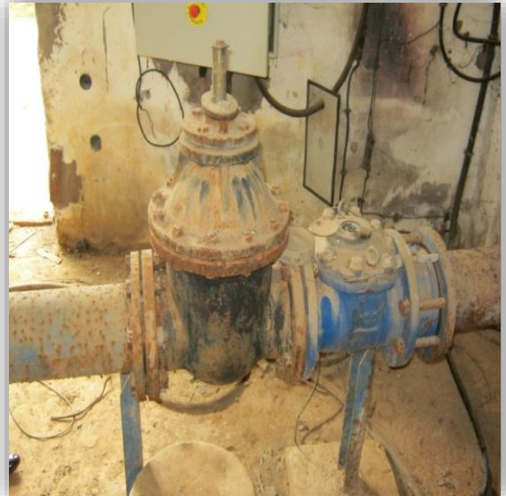
Figure III.4 : Vue d'une vanne du forage 3
