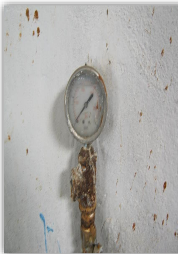
Figure III.2 : Dégradation et arrêt de manomètre du forage 2
