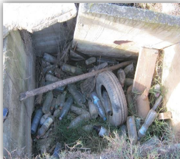
Figure III.13 : Vue intérieure d'un regard de vannes
