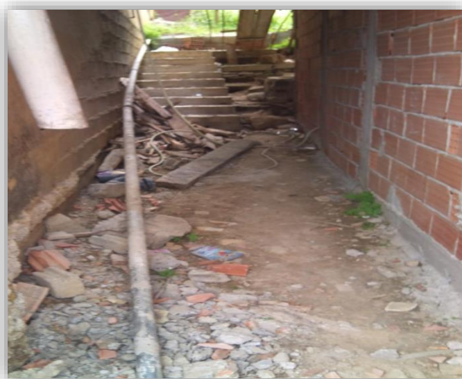
Figure III.15 : Conduite de distribution en acier agressée et non sécurisée
