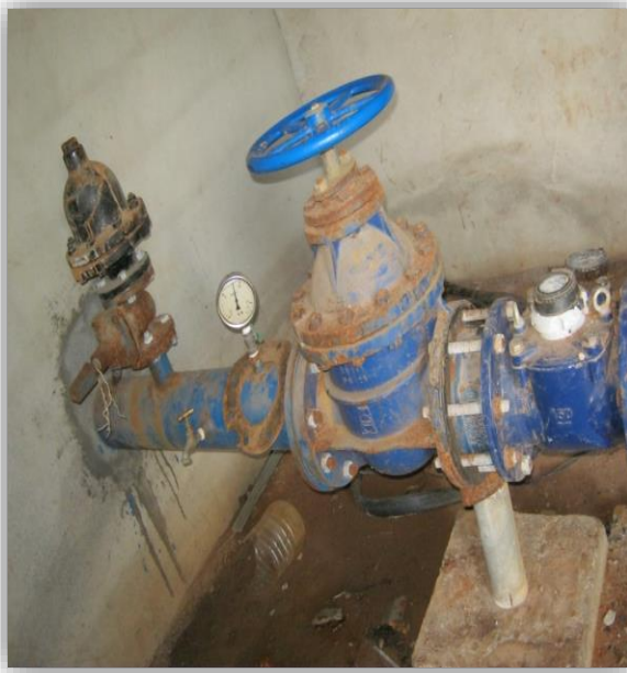
Figure III.7 : Accessoires électromécaniques et électriques du forage 8
