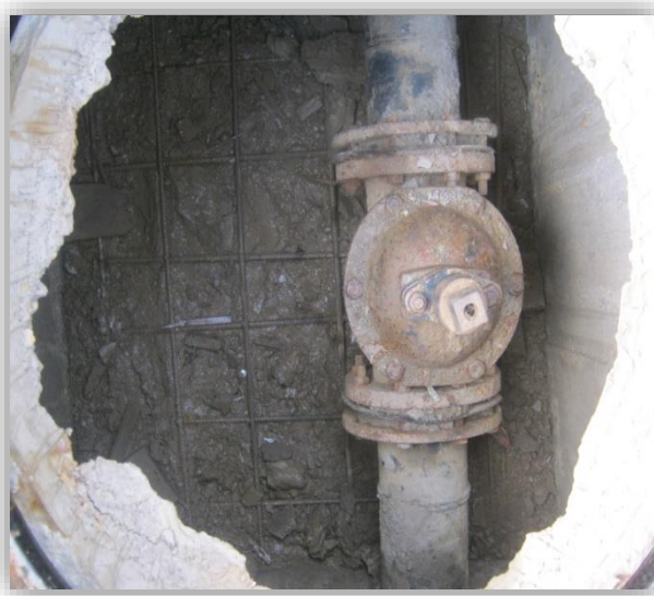
Figure III.16 : Vue d'un regard de vanne corrodé
