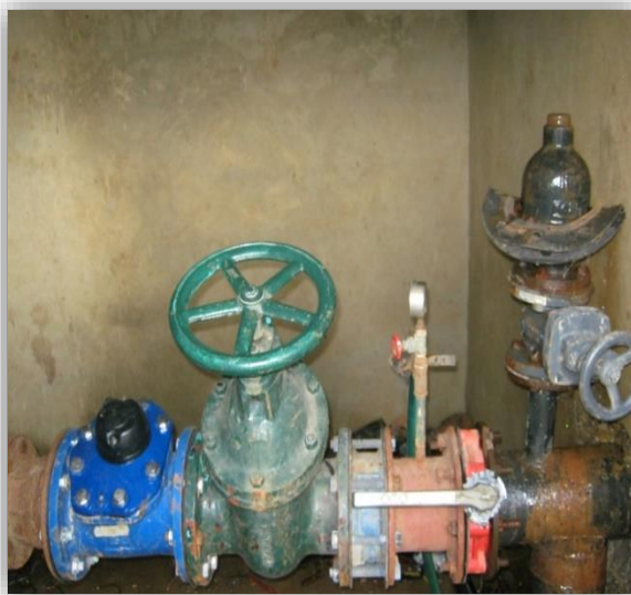
Figure III.9 : Fuites au niveau de la ventouse du forage 9
