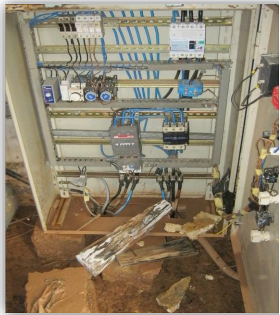
Figure III.6 : Dégradation du toit et la distance non respecté entre l'armoire électrique et le sol du forage 4
