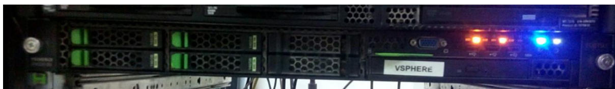
Figure 4.1 serveurs Fujitsu Primer gy RX200 S5
