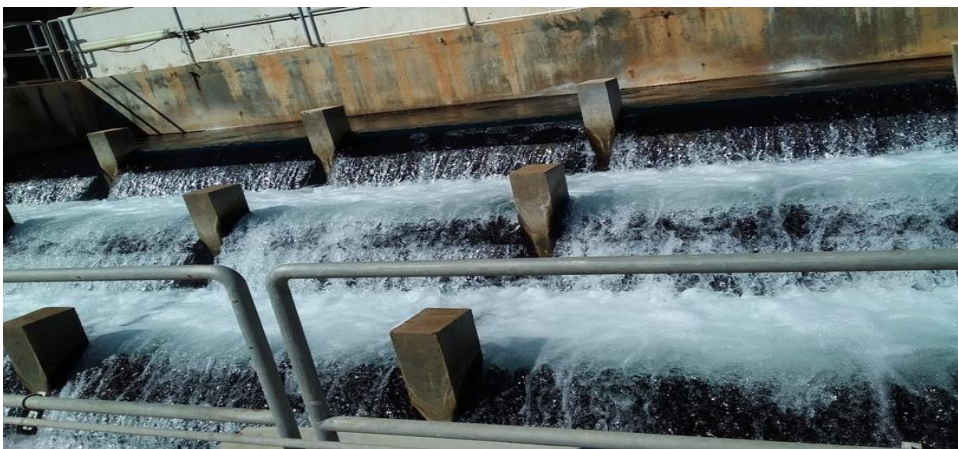
Figure II.3 : Photographie représentant la cascade d'aération.
