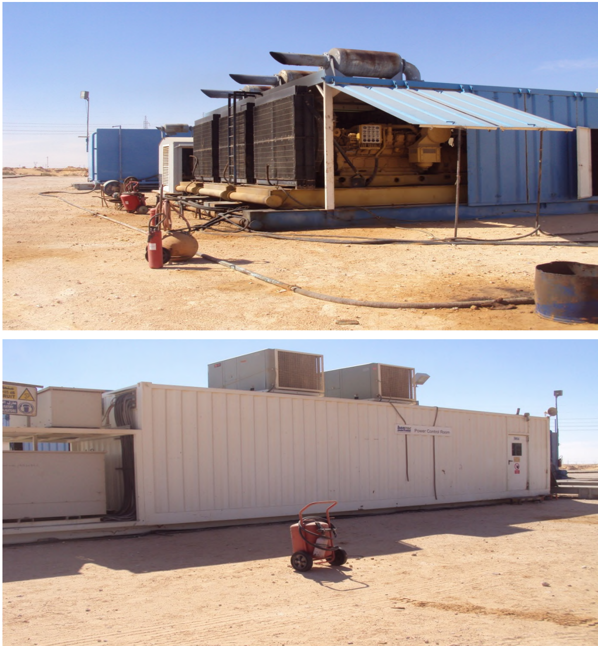
Figure 28 : les moteurs diesel et la centrale électrique TP 201. (12/03/2015).
